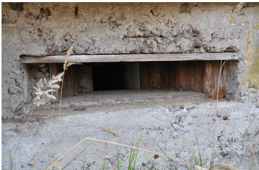
Strzelnica schronu bojowego w Rozprzy z widocznymi pozostałościami szalunku
